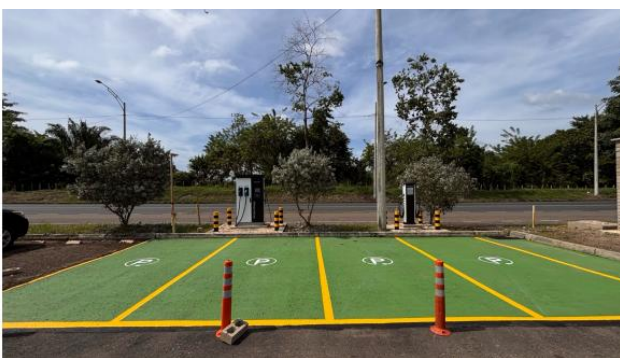
Estación de Recarga San Onofre
